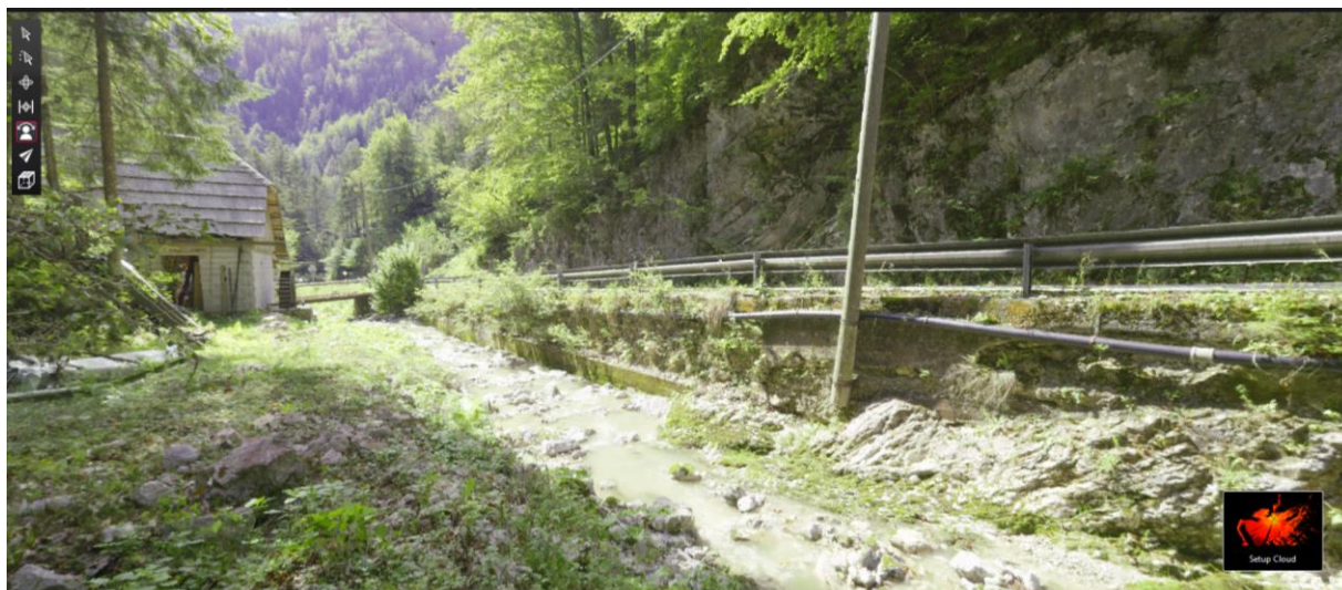
Slika 4. Pogled od P11 dolvodno proti obstoječemu mlinu, kjer je betonski zid deformiran, vidno je da je, kljub dobetonirani peti ob vznožju zidu prišlo do spodkopavanja. Viden potek telekomunikacije in nadzemnega elektro vodo.
