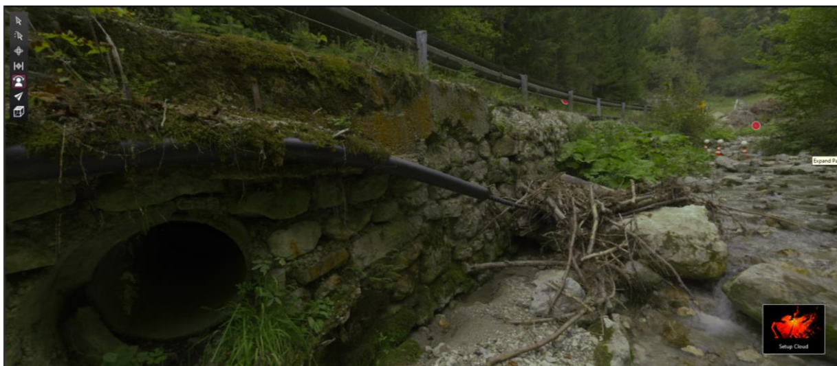
Slika 19. Pogled gorvodno iz območja P30, kjer so rege izprane, kamni izrinjeni, betonska krona je v fazi razpadanja, v nadaljevanju je porušen zid poškodoval telekomunikacijski kabel.
