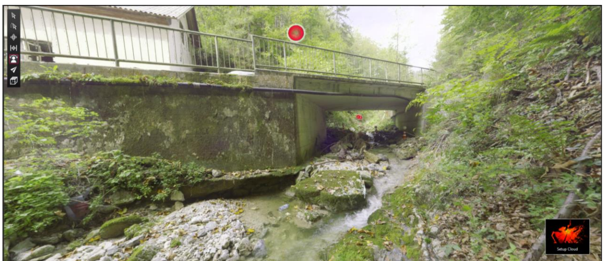
Slika 24. Pogled od P38 gorvodno proti mostu, kjer se vidi spodkopen krilni zid, temeljenje mostu je dobro.
