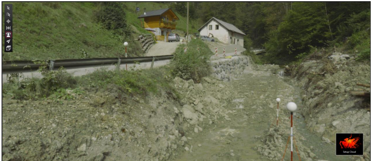
Slika 22. Pogled od P35 gorvodno kjer se je leta 2019 v P37 porušil zid in je bil leta 2020 izveden novi zid.
