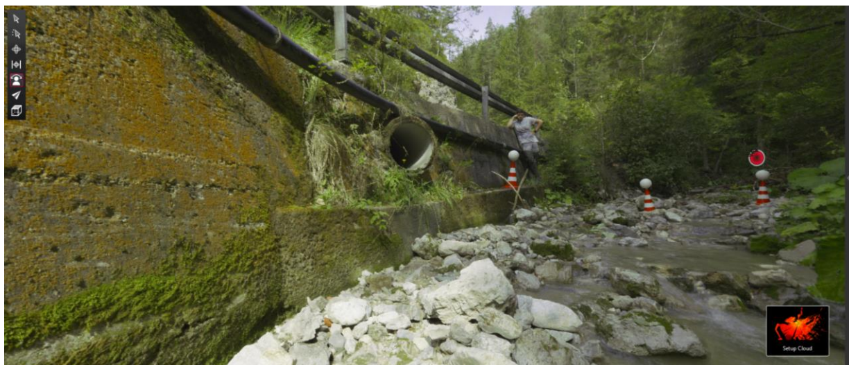
Slika 1. Pogled gorvodno po strugi od P3, kjer se v preteklosti dobetonirana peta.
