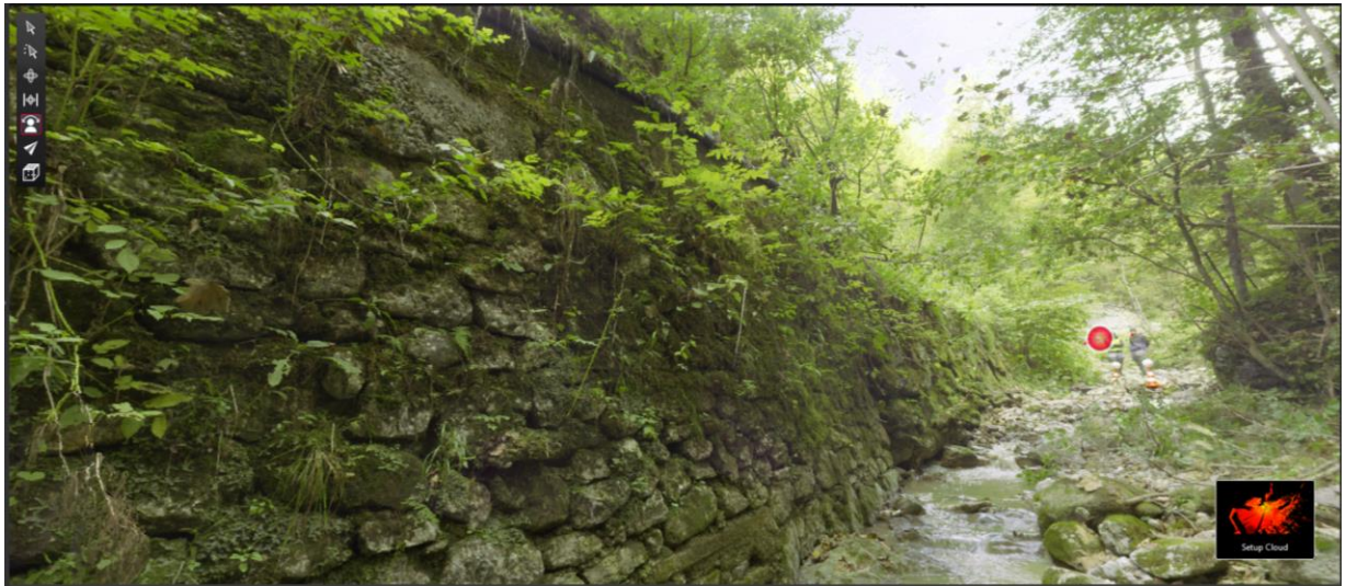
Slika 16. Pogled gorvodno od od P22, kjer so vidne izpadle rege in deformacije zidu.
