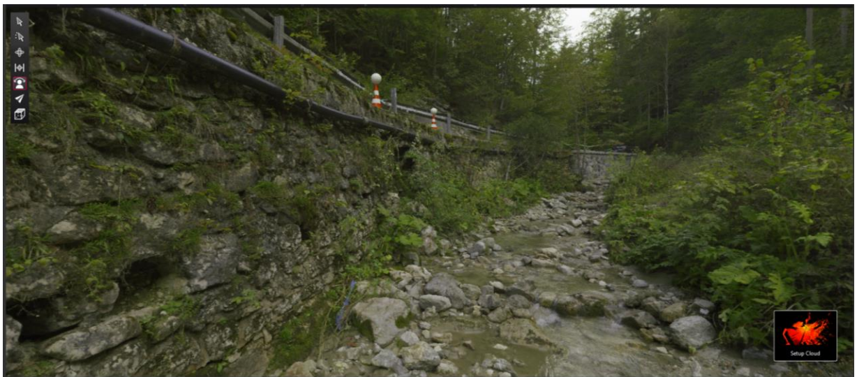
Slika 17. Pogled gorvodno od P24, v območje, kjer se zid porušil in je bil v letu 2020 izveden novi zid.
