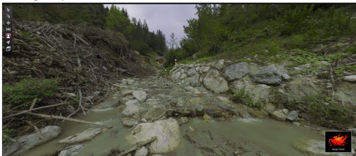
Slika 21. Pogled na neprimerno in nestrokovno odlaganje vej in ostalega lesa v P34, vidno je da so lesni odpadki že delno padli v strugi, to pa lahko ima za posledici večjo zaježitev dolvodno itd....
