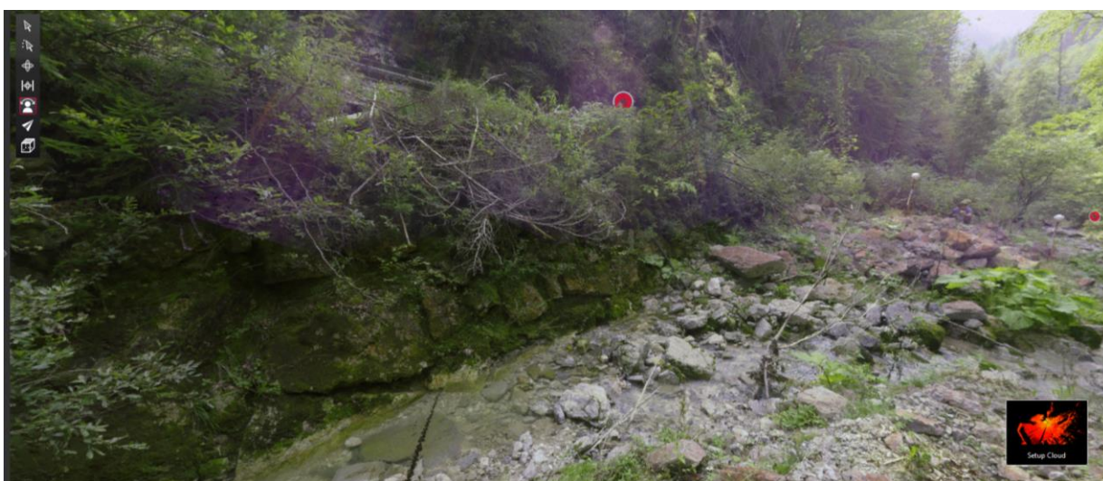
Slika 27. Pogled dolvodno v območje P48, kjer se je zid porušil.
