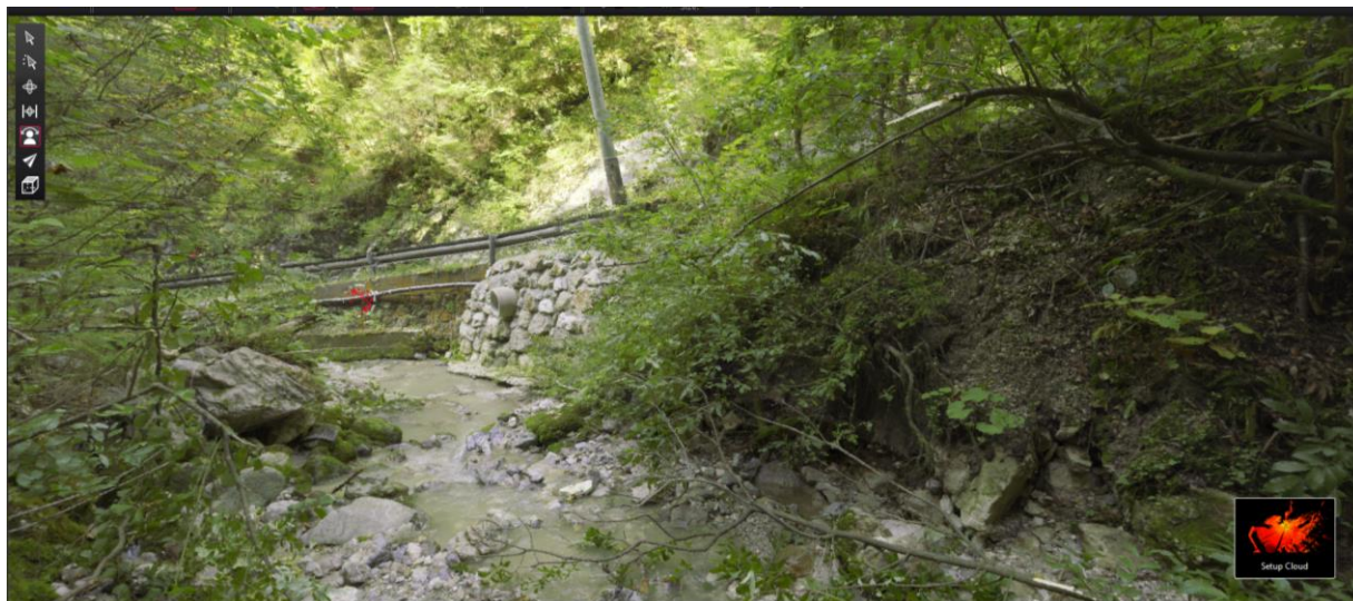
Slika 10. Pogled dolvodno P17, kjer je gorvodno porušen kamniti zid.
