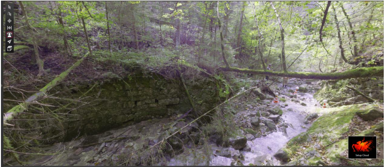
Slika 28. Pogled dolvodno na poškodovani zid iz območja P49.
