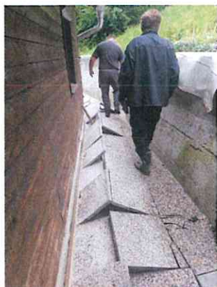
Fotografija 1: Močno razpokana stanovanjska hiša, oporni zid in dvignjeni tlakovci ob objektu (avgust 2023)
