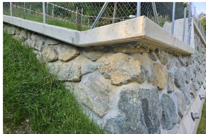
Sanacija plazu Pristava.
