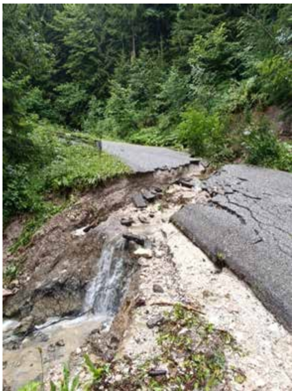
Uničeno cestišče, pogled gorvodno, na dan poplav blizu športnega igrišča.
